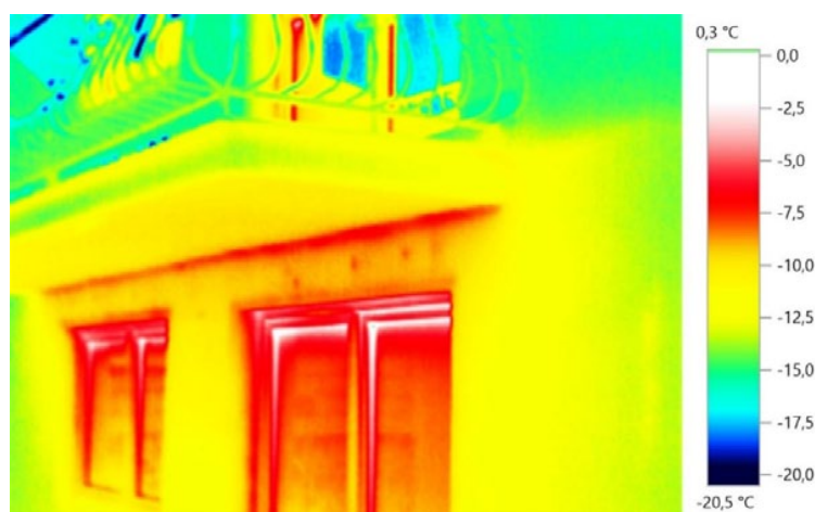
Rys. 2. Termogram połączenia okien ze ścianą zewnętrzną (opracowanie własne)
